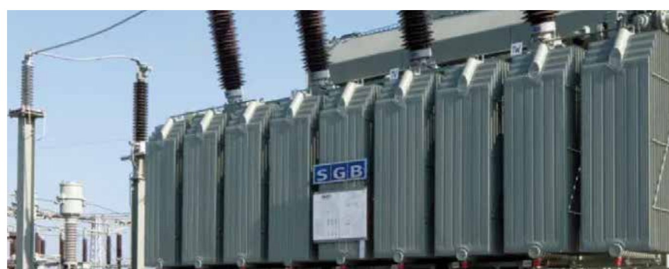
▶ Estabilizadores e transformadores
